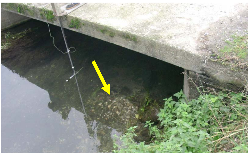
Fig. 57 – Disturbo provocato da cumulo di materiale grossolano accumulatosi in seguito a pulitura del fondale.
