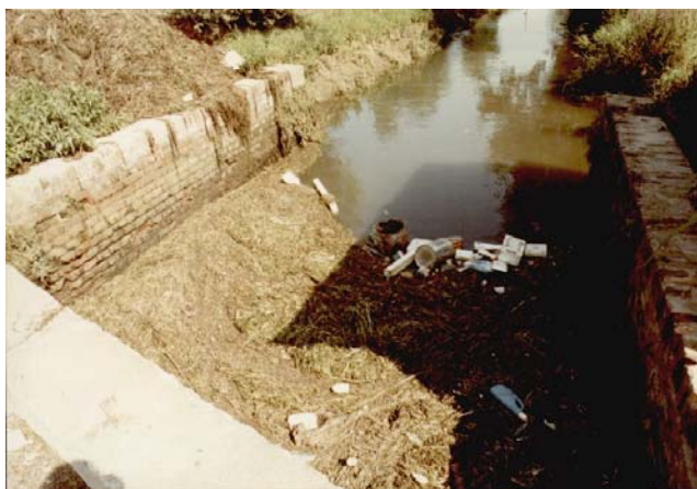
Fig. 24 - Esempio di canale sporco
